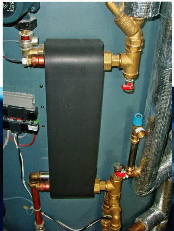
Die Pufferspeicher sind mit außenliegenden Plattenwärmetauschern ausgestattet.
